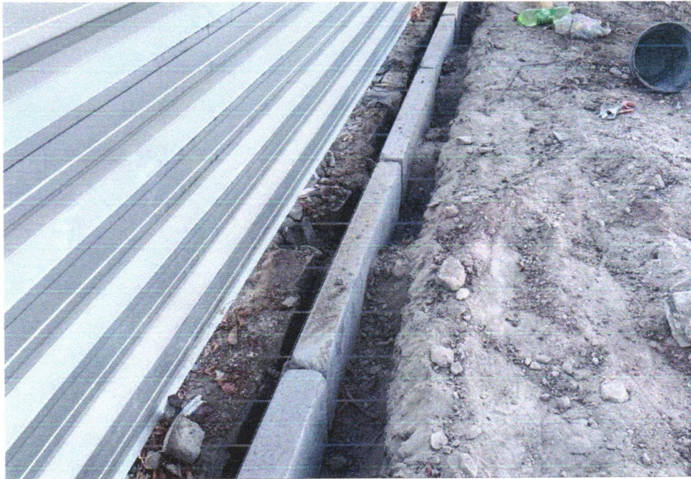
Foto 09- ASSENTAMENTO DE GUIA (MEIO-FIO) EM TRECHO RETO, CONFECCIONADA EM CONCRETO PRÉ-FABRICADO, DIMENSÕES 100X15X13X20 CM (COMPRIMENTO X BASE INFERIOR X BASE SUPERIOR X ALTURA), PARA URBANIZAÇÃO INTERNA DE EMPREENHIMENTOS. AF_06/2016_P
